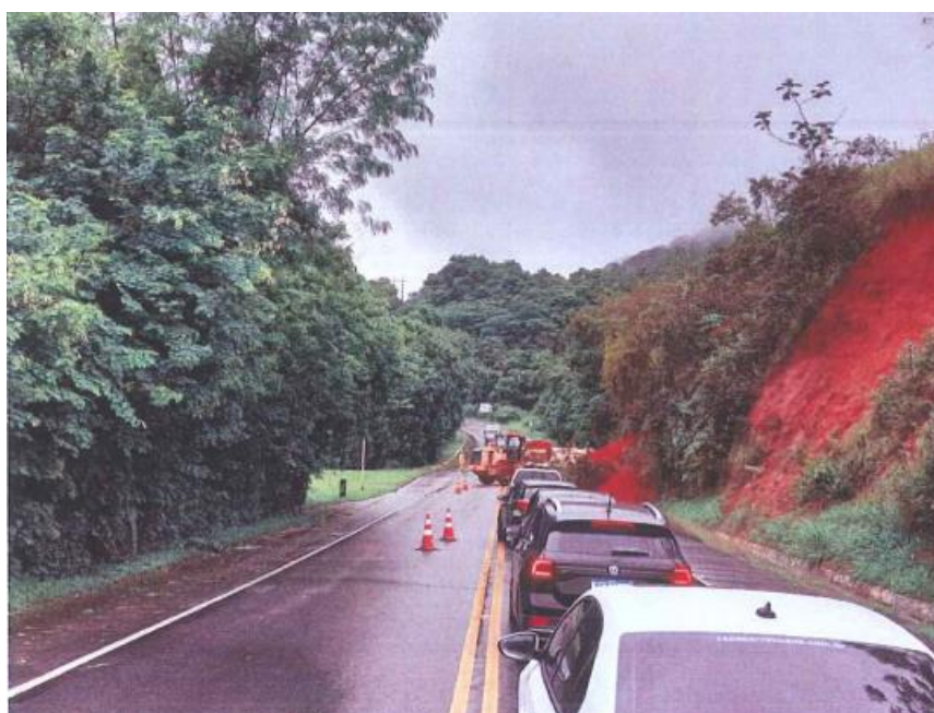
Foto 6 – Queda de barreira – Km 034+400 [2]
