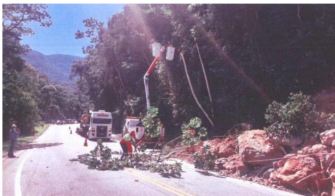
Foto 8 – Queda de barreira – Km 051+900 [2]
