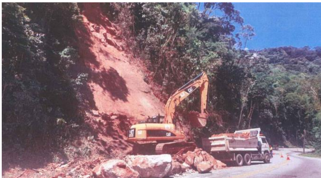
Foto 7 – Queda de barreira Km 051+900 [1]
